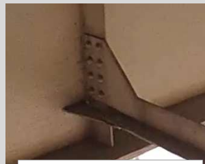
点検が困難なボルトの状態確認
